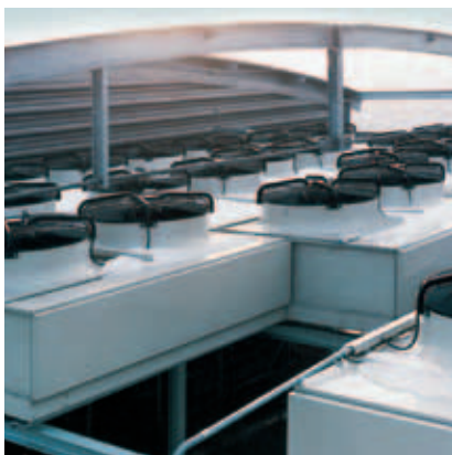
Koelluchtbevordering door sikkellventilatoren
